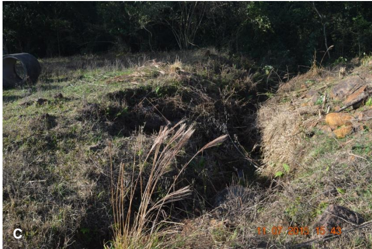
Figura 53. (A) Microdrenagem superficial em via com pedra irregular. (B) Ponto de lançamento de macrodrenagem. (C) Sulco de erosão formado pelo caminho preferencial da água da chuva. 31 (388), 131 (107, 108)
