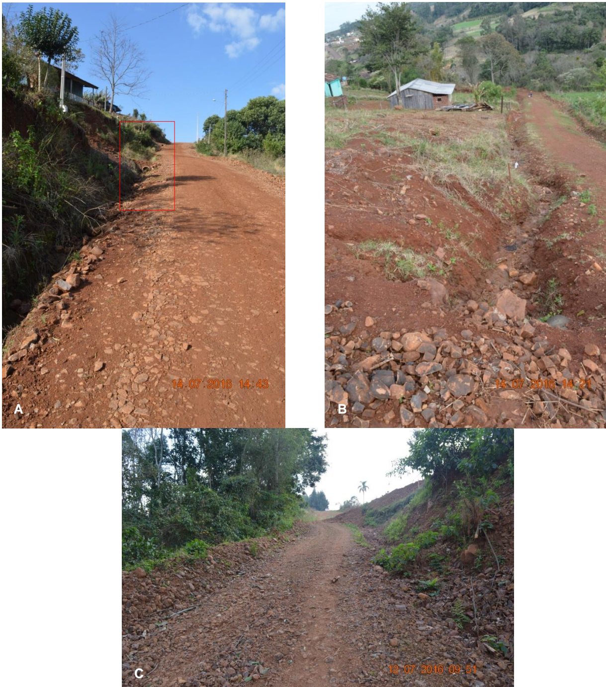
Figura 54. (A) Estrada de chão com foco na manilha utilizada para acesso às residências, (B) Valetas sem manutenção e (C) Estrada de chão cascalhada com utilização de leira como estrutura de drenagem pluvial. 100 (489); 98 (466) e 10(72)
