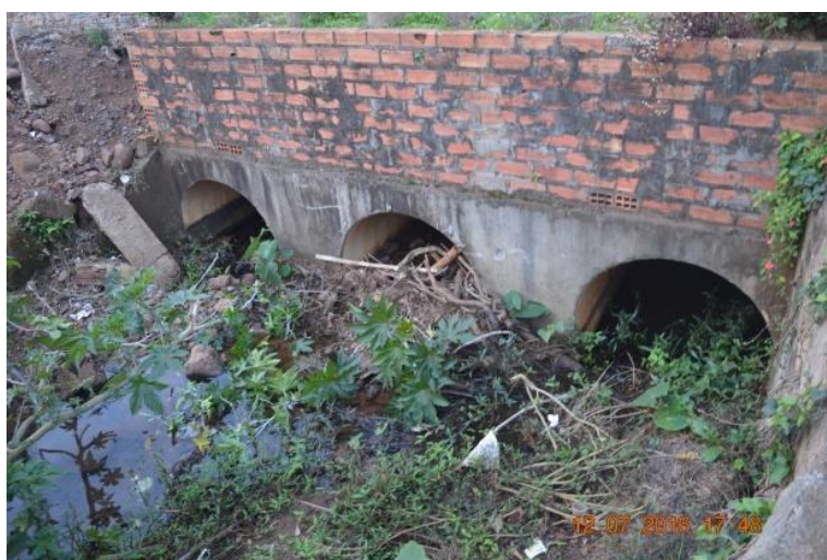
Figura 58. Manilhas parcialmente entupidas pelo acúmulo de sedimentos. 33 (420)
