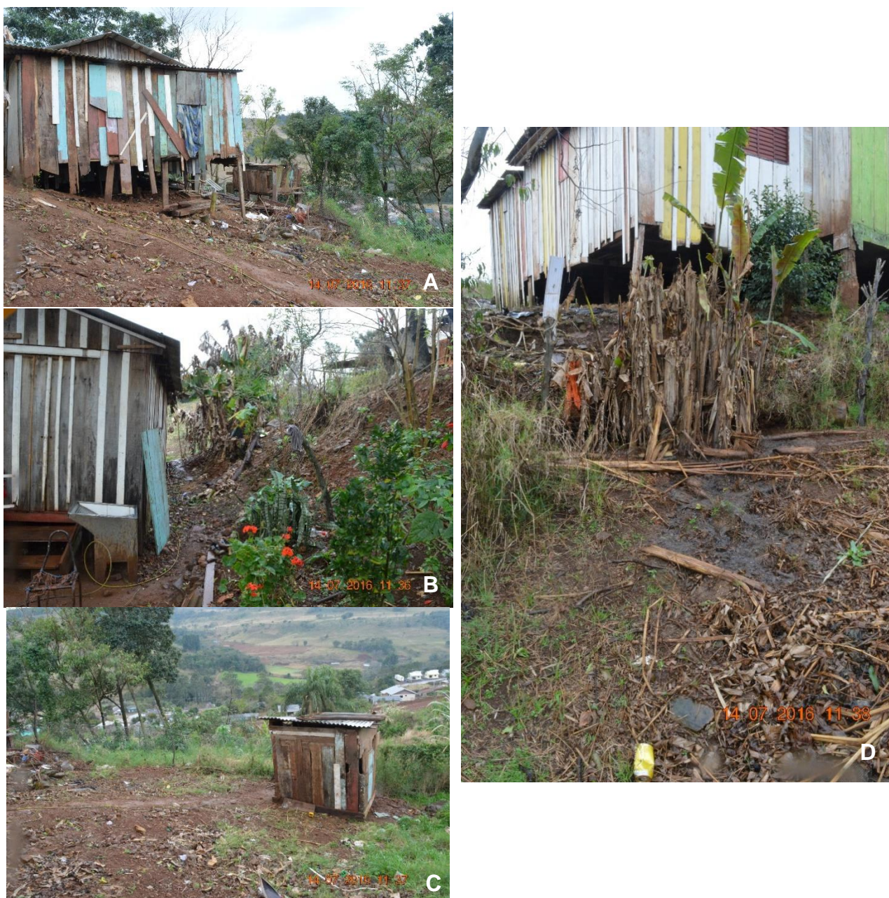
Figura 92. Edificação localizada em área de risco (Ponto 094, Figura 87 ).
