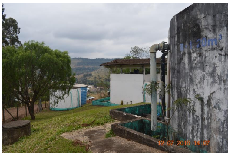
Figura 33. Estação de tratamento de água em Saltinho, Santa Catarina.
