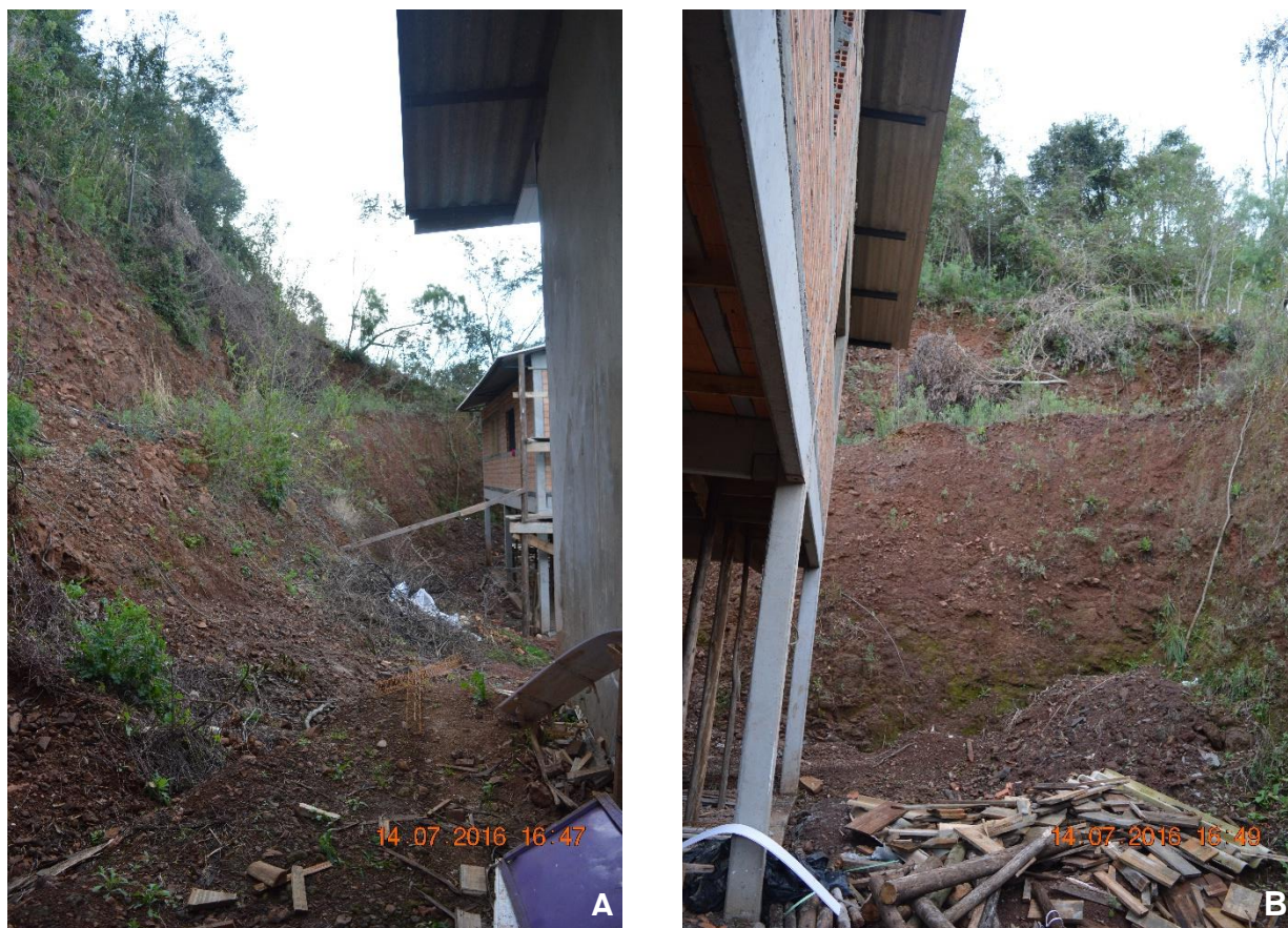
Figura 107. Área de risco localizada no Ponto 114 da Figura 103 .
