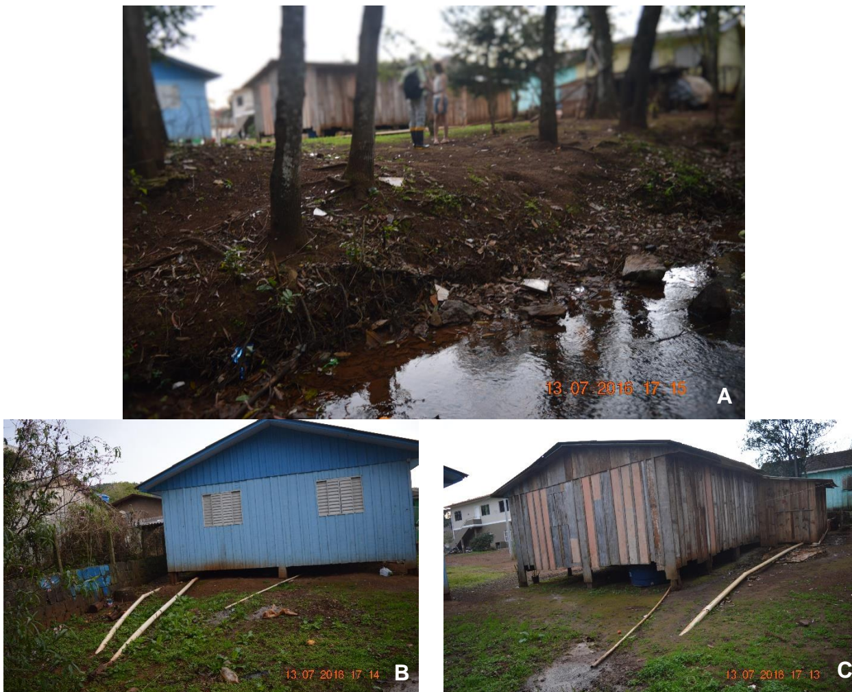
Figura 75. Área de risco localizada no Ponto 078 da Figura 66.
