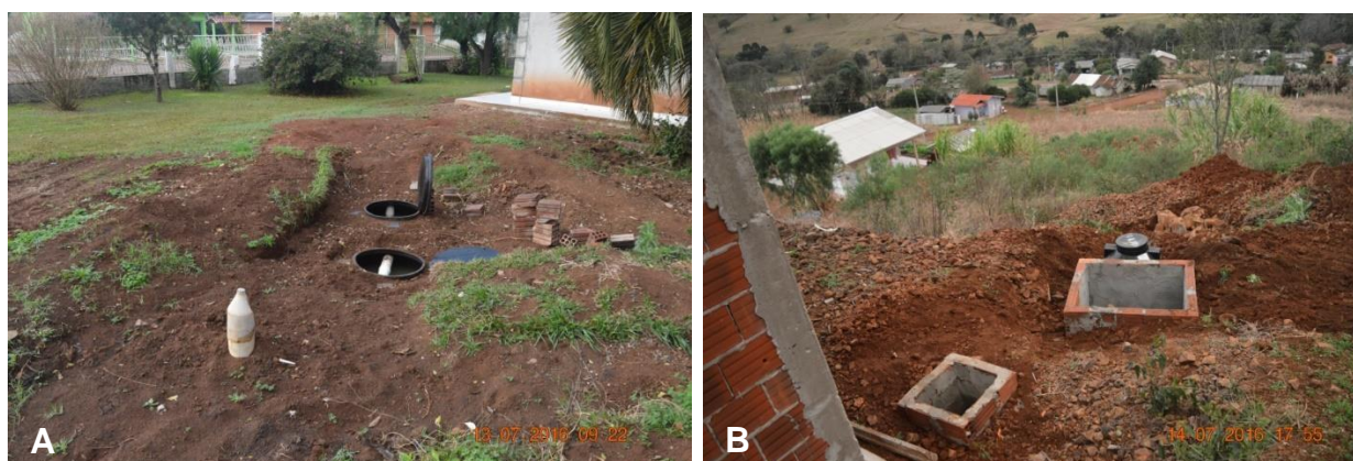
Figura 40. (A) Sistema fossa séptica e filtro anaeróbio em polietileno, seguido do sumidouro (B) Caixa de gordura e fossa séptica em alvenaria e filtro anaeróbio em polietileno, seguido de sumidouro.
