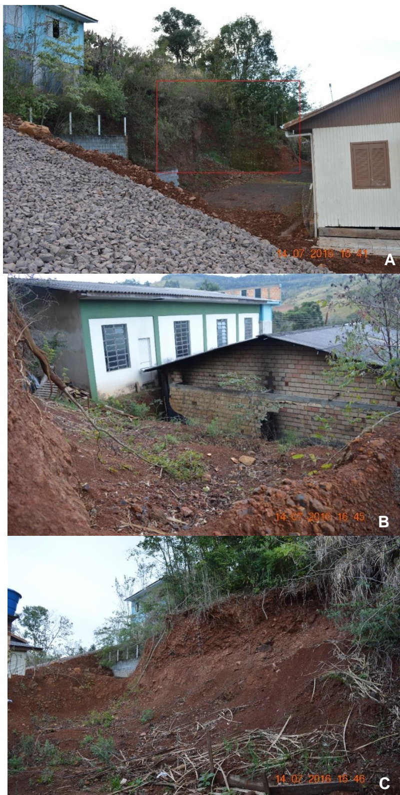
Figura 106. Área de risco identificada como Ponto 113 na Figura 103 .
